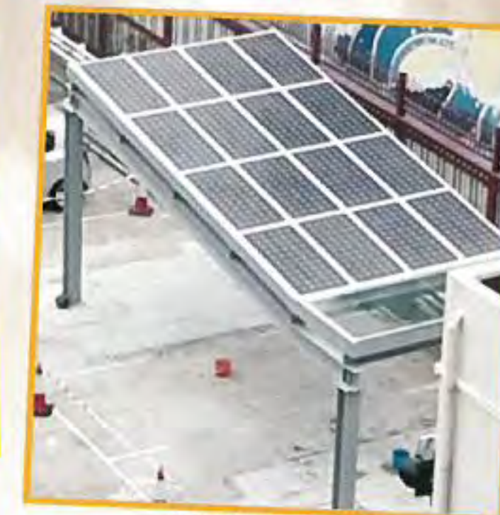
太陽能供電系統
